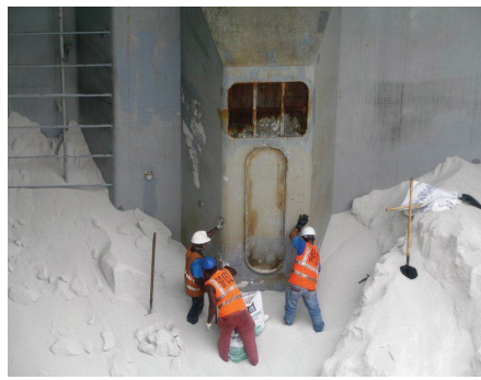
Retirando producto dañado de la bodega de carga
